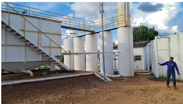
Figura 4 - ETA, filtros, câmara de contato e reservatórios
