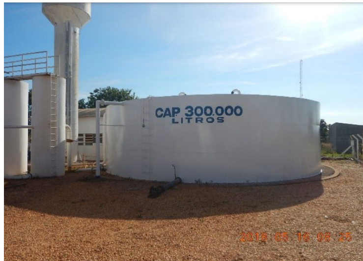
Figura 5 - Detalhes dos reservatórios
